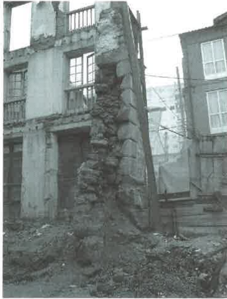
Foto 1: Estado de Porta da Aira antes de la intervención.
