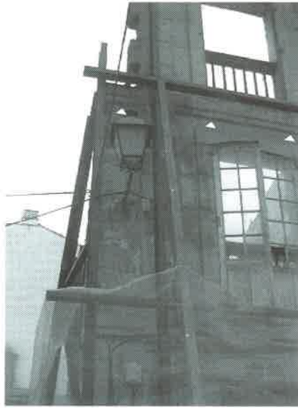
Foto 9: Moldura decorativa de la fachada n° 42 (acción 3) que continúa sobre el machón (acción 2), indicando la contemporaneidad de ambos.
