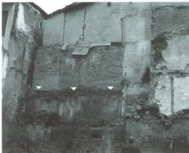
Foto 4: Viga de madera (marcada por las flechas) embutida en la medianera de forma longitudinal.
