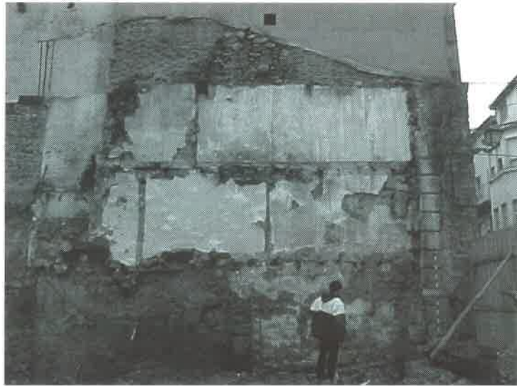
Foto 2: Vista general de la medianera una vez demolidas las edificaciones de C/Lugo nº 11 y C/Julio Prieto Nespereira nº 44 esquina C/Lugo nº 13.
