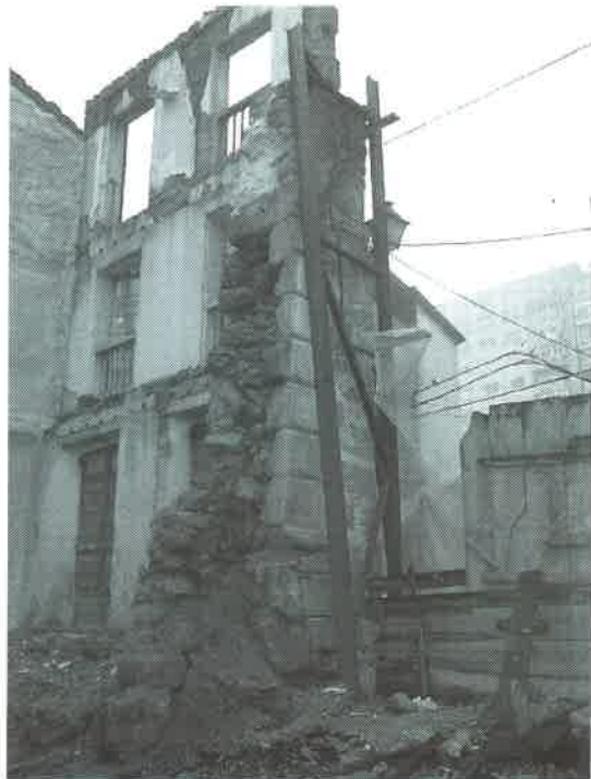
Foto 10: Continuidad constructiva del machón y de la prolongación de fachada del n° 42.
