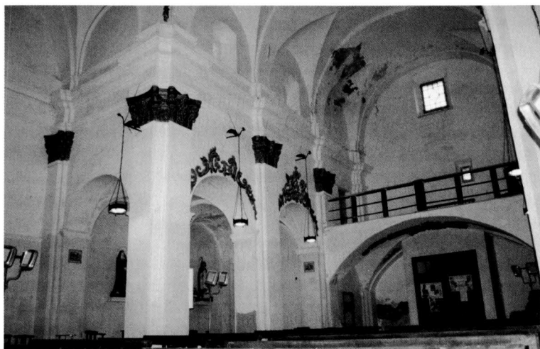
(Fig.7) Vista de la nau de l'espístola, cor i voltes de l'església d'Alcanó
