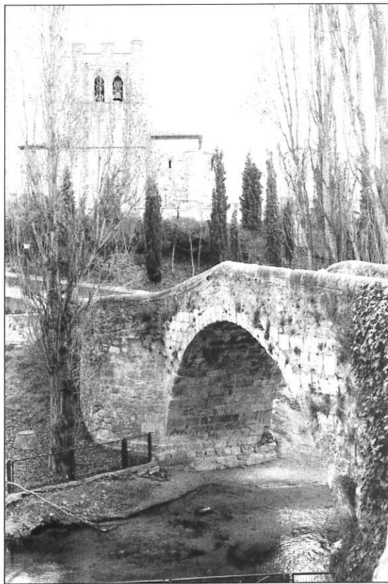
Figura 3. Puente de las Tenerías en Aranda. Su fina rosca de cantería y el despiece de los sillares, parece obra original del XVI ó XVII, con múltiples reparaciones posteriores, entre las que se cuenta el pretil y el apartadero en la rampa, una característica de los puentes arandinos.
