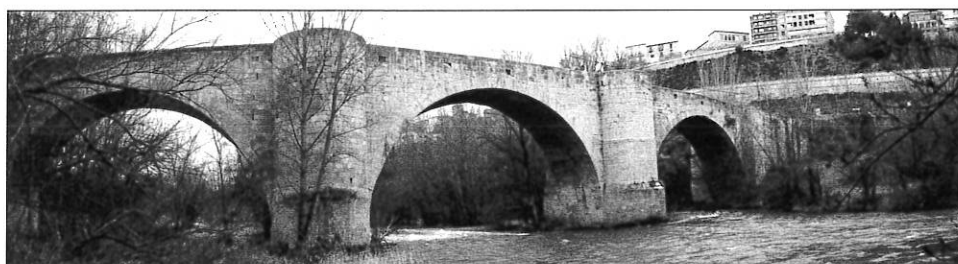
Figura 39. Vista general del puente de Roa, reducidos a 3 los arcos, de los 5 que tuvo.
