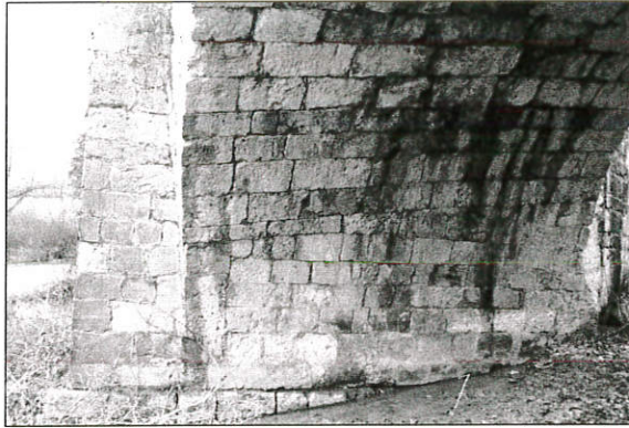
Figura 25. Estado de la 3. a pila del puente de La Vid. Su hundimiento debió provocar el derrumbe de los dos arcos que apoyaban en ella. En la reconstrucción dieciochesca se consideró que ya estaba suficientemente asentada.
