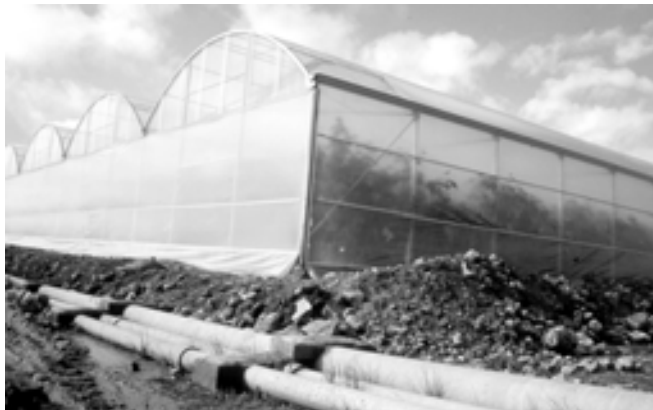
La «estructura multitúnel» está siendo la más utilizada por sus mayores prestaciones en instalaciones avanzadas
