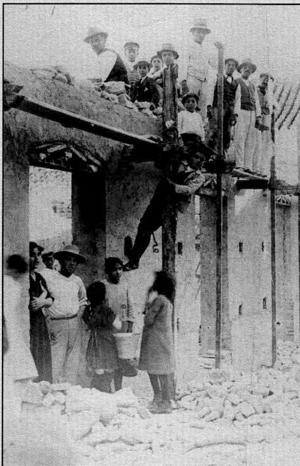
Construcción en 1914 de la casa donde en su origen estuvo el establecimiento de comestibles de Juan Triviño Benítez y posteriormente la frutería de Francisco Criado Ramírez.
