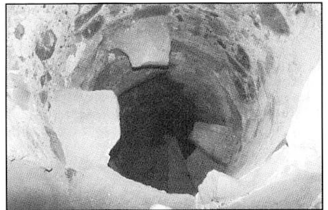
Vista cenital del hueco de escalera de la Torre de Guadalmesí. Este primer tramo está arruinado como el que asciende hasta el terrado. (Foto Á. Sáez)
