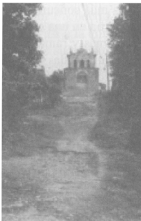
Estado ruinoso actual del Templo de La Popa y la calzada de acceso. Enero de 1998.
