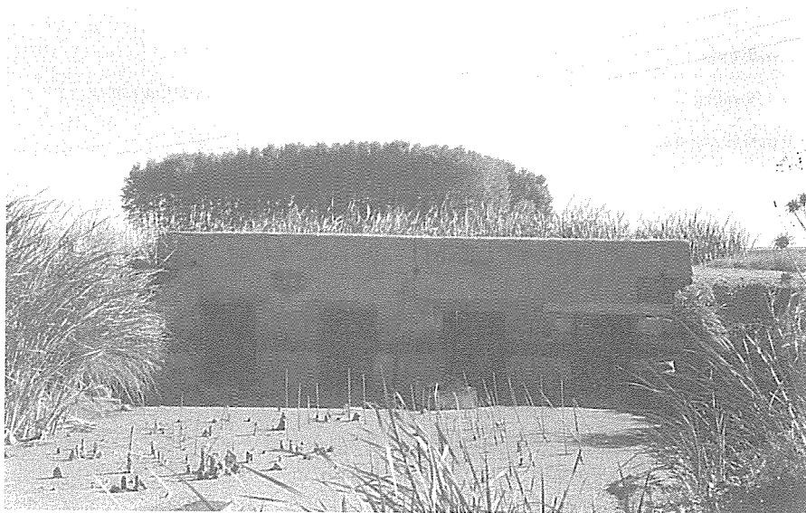
Fig. 3.- «Las Alcantarillas» aguas abajo, donde la vía cruzaba «el arroyo», antiguo «Regum», que dio nombre a Riego del Camino.
