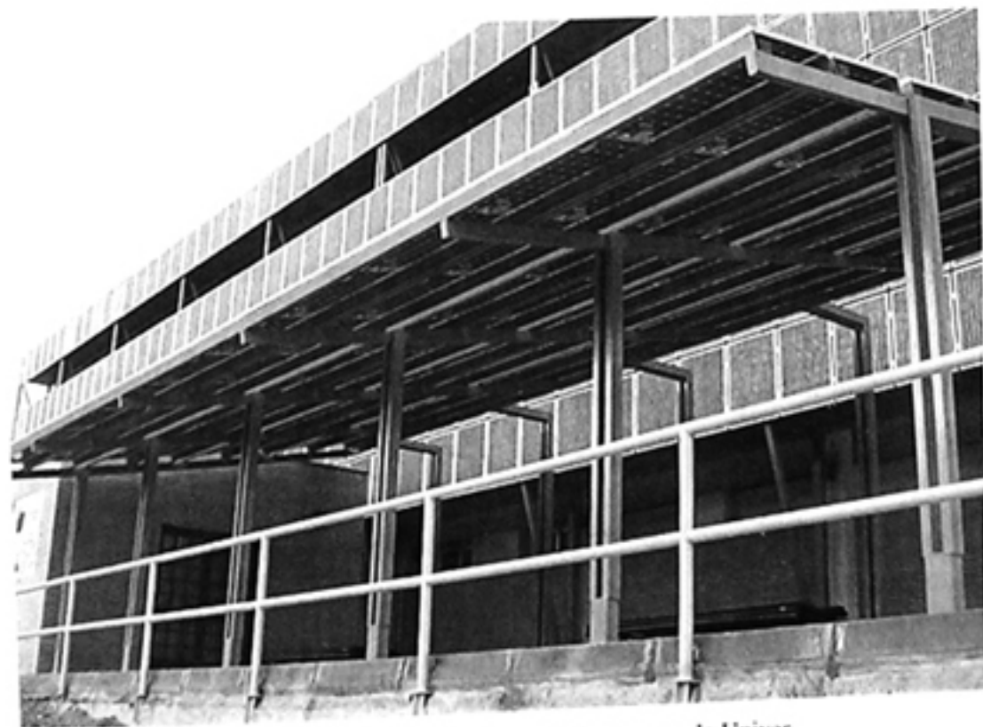
Figura 26. —Detalle pérgola caseta inversores de Univer.
