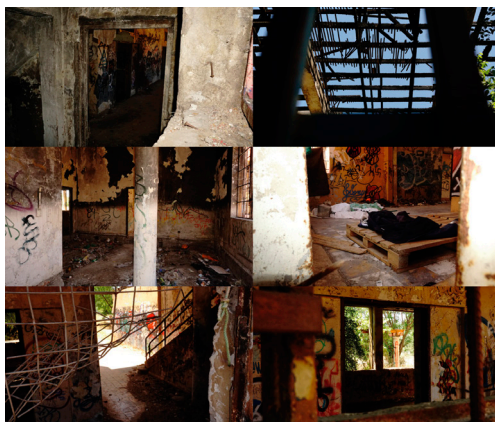
Fig. 7. Daños materiales y estado de las Escuelas Concentradas de Talca después del incendio de 2015. Fuente: fotografías de William Urrutia Román, 2025.
