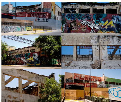
Fig. 6. Daños materiales y estado de las Escuelas Concentradas de Talca después del terremoto de 2010. Fuente: fotografías de William Urrutia Román, 2025.
