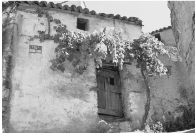
FIG. 9. Vivienda abandonada abocada a desaparecer (Roturas).
