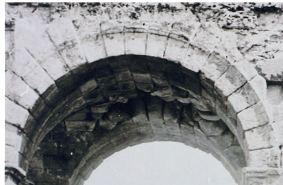
Fig. 4. Detalle de la bóveda del tetrapylon de Cáparra (a partir de la fotografía tomada el 24 de agosto de 1901, AHPCC., Legado V. Paredes, 19.01, 14:1402).
