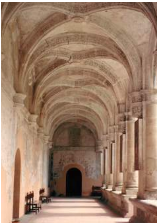
Bóveda de las bodegas del convento de santo Domingo de Oaxaca (Mexico)
