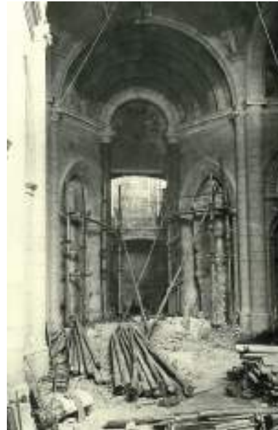
Proceso de los trabajos en la reconstrucción cabecera y crucero del templo
