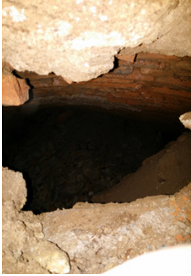
Fig. 14: En la imagen se puede apreciar la cámara inundada de escombros y el techo abovedado. Fotografía: Manuel Toro Rosa.
