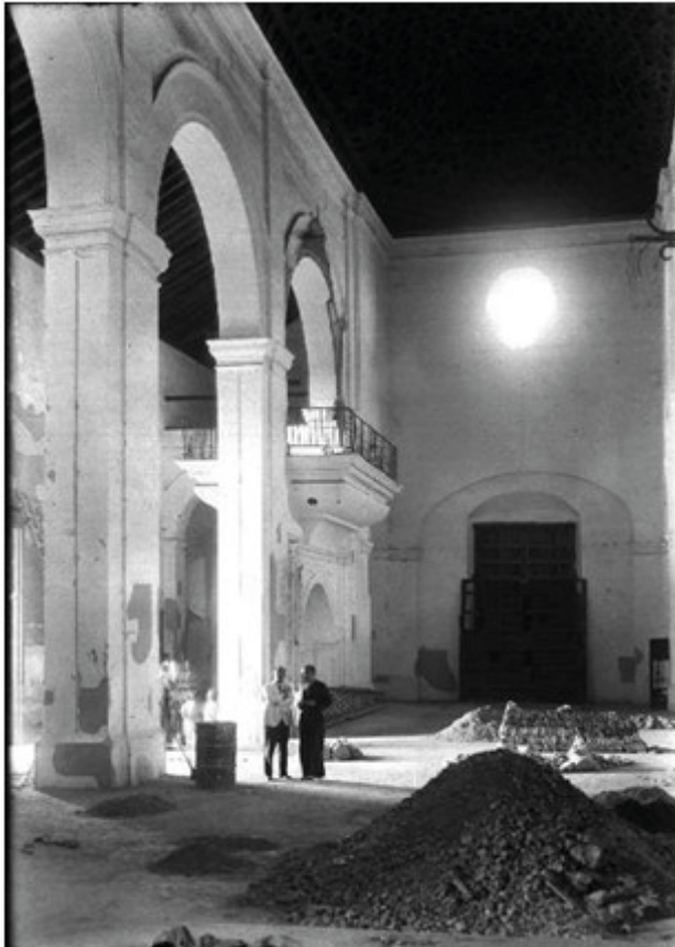
Figura 2. Imagen donde puede observarse la Tribuna de los Condes, y que desgraciadamente sería demolida en la rehabilitación del templo de 1938.
