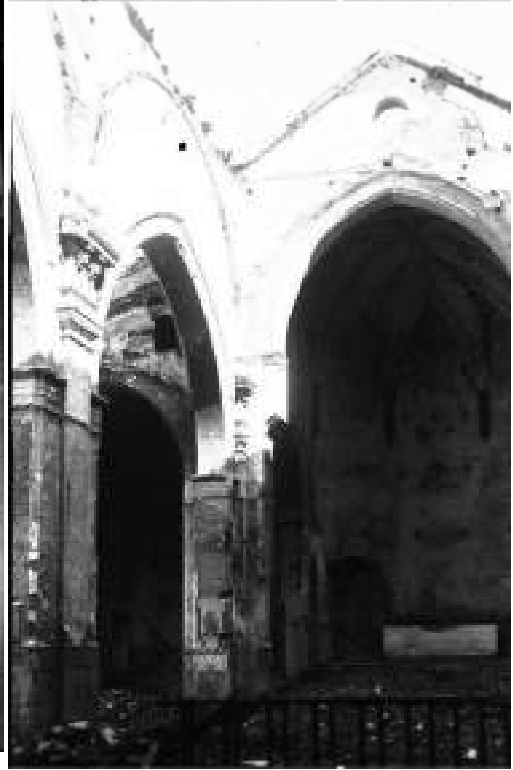
Figura 5. Detalle del estado de conservación del presbiterio de la Iglesia de Ntra. Sra. de la Encarnación de Constantina tras los sucesos de 1936.
