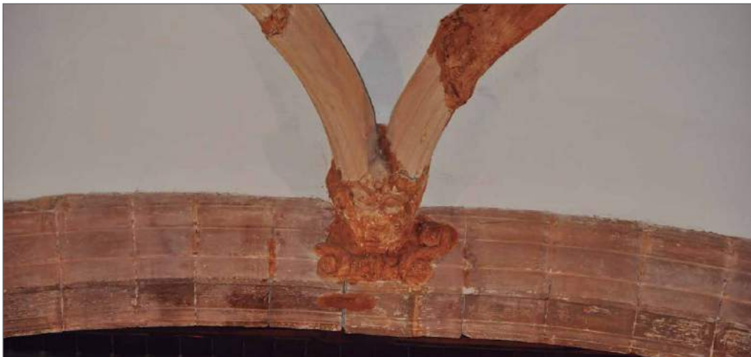
Fig. 31 Los daños sufridos por la bóveda de Egas en el siglo XVII siguen siendo visibles
