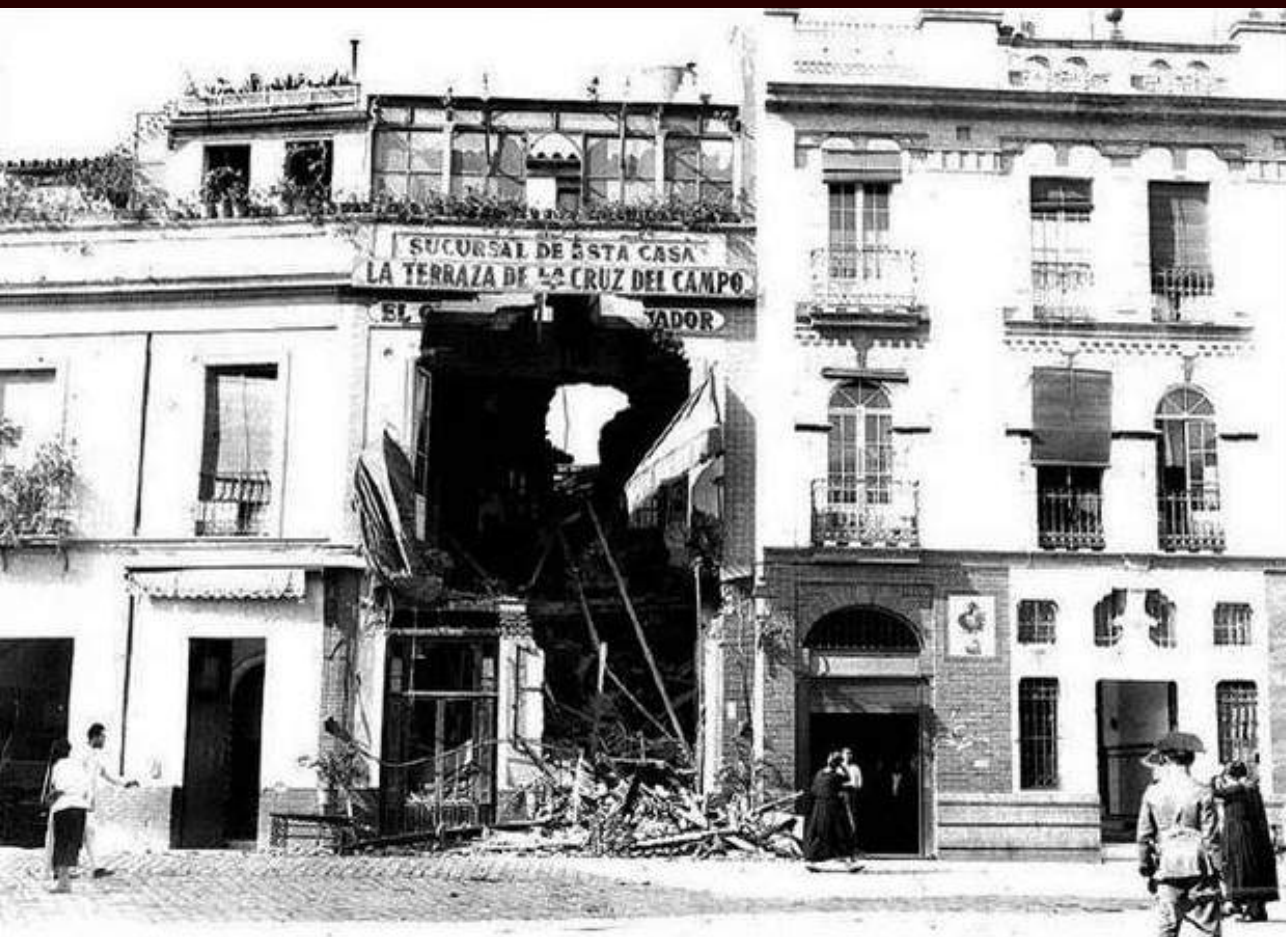
Estado en que quedó Casa Cornelio tras el bombardeo. La casa que aparece a la izquierda de la imagen, que en sus bajos albergaba una cochera, es donde vivía la familia Mazón. © ICAS, SAHP, Fototeca Municipal de Sevilla, Archivo Serrano.
