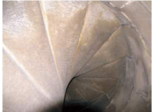
Interior del caracol de husillo ubicado en la cabecera de la Iglesia (nave de la epístola). Fotografía cortesía de Manuel y Francisco Basallote Neto (arquitectos)
