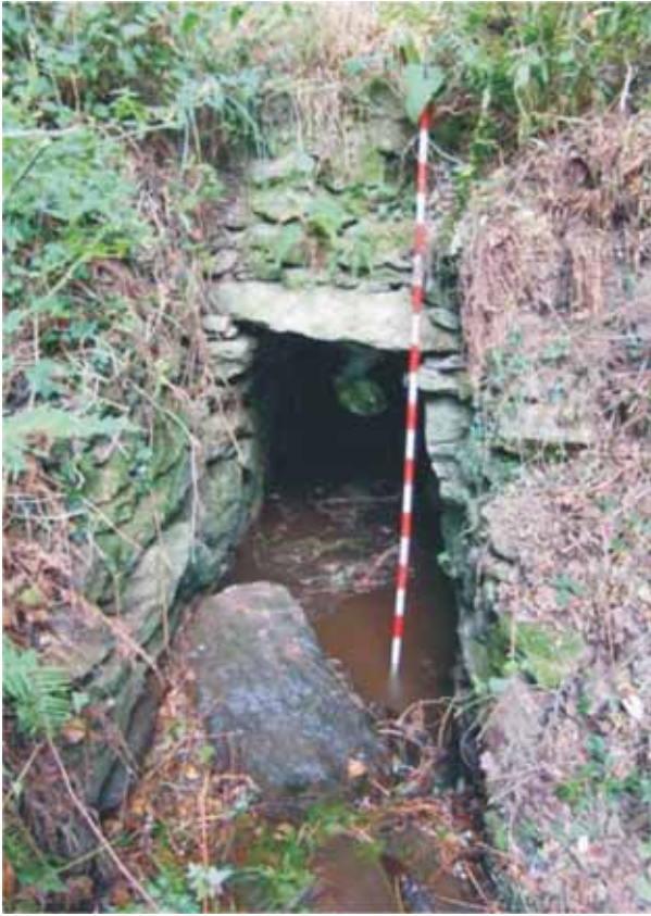
Pontella en Balcóns (Irixoa), Camiño Real Betanzos-Vilalba. Estribos de pedra e plataforma con laxes de pedra.
