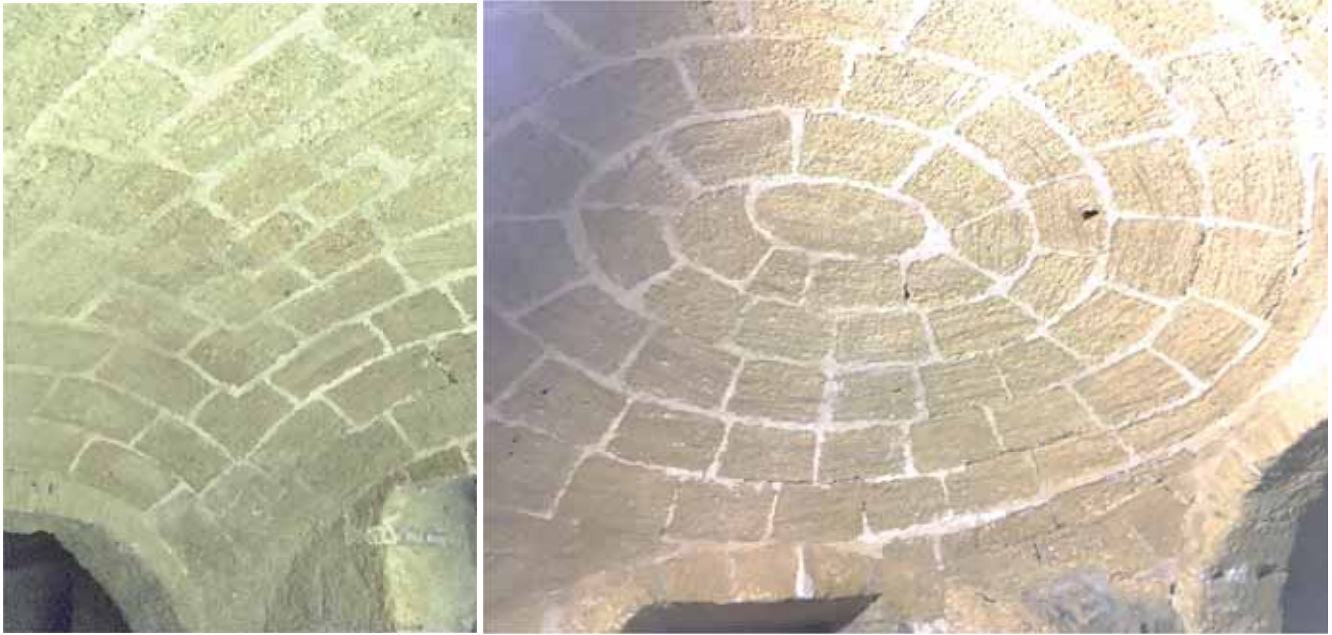
DOS BÓVEDAS VAÍDAS DE LAS QUE CIERRAN LOS SÓTANOS DE LA CILLA DEL CABILDO: LA PRIMERA, DE RECUADROS CON SILLARES ANGULARES PARA PERMITIR EL MONTAJE EN RECUADRO SIN CIMBRA CUAJADA; Y LA SEGUNDA, EN VUELTA DE HORNO PARA MONTAJE EN ESPIRAL TAMBIÉN SIN CIMBRA. (FOTOGRAFÍA DEL AUTOR)
