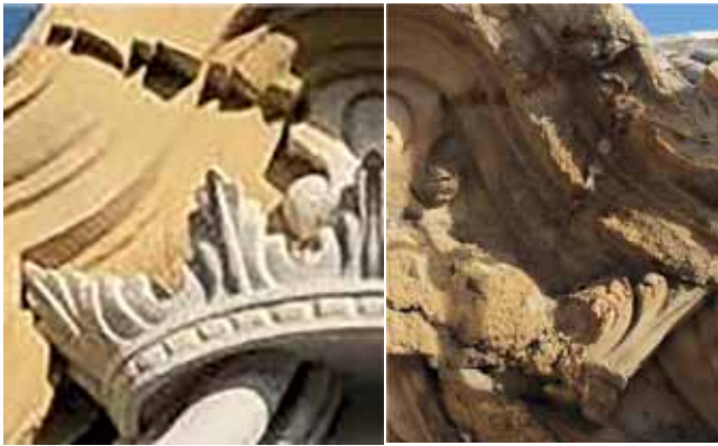
DETALLE DE LA CORONA DE REMATE ANTES Y DESPUÉS DE LA INTERVENCIÓN. (FUENTE: INFORME DE LA RESTAURADORA)
