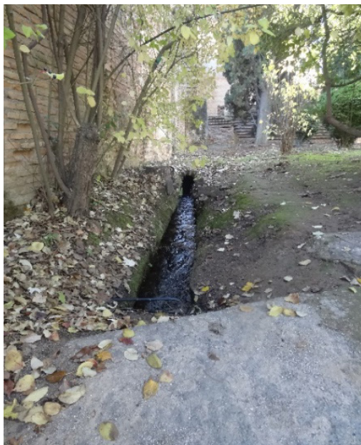
Fig. 12. Ramal que surte la zona central de la Carrera (Fotos C. Vílchez).
