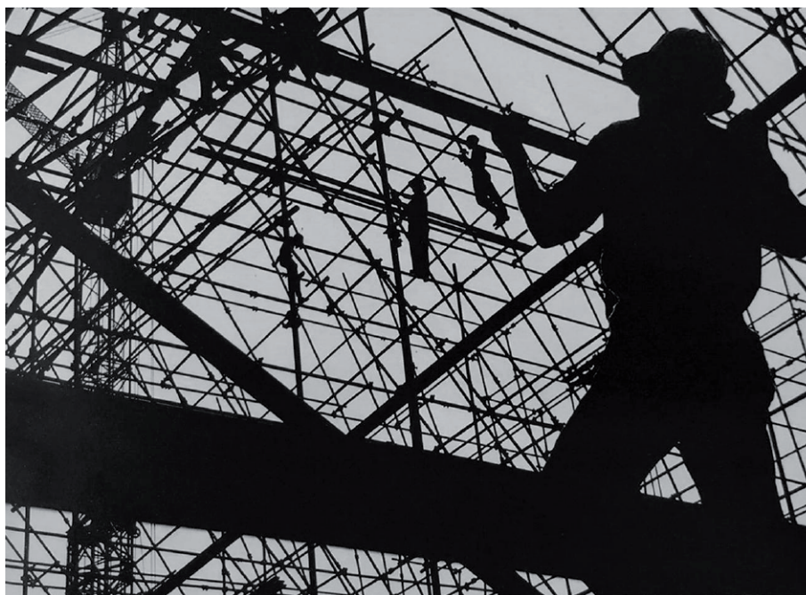
Figura 1. Montagem da estrutura metálica para a construção das fábricas da União Fabril do Azoto da Companhia União Fabril, no Lavradio. Fotografia de Augusto Cabrita.
