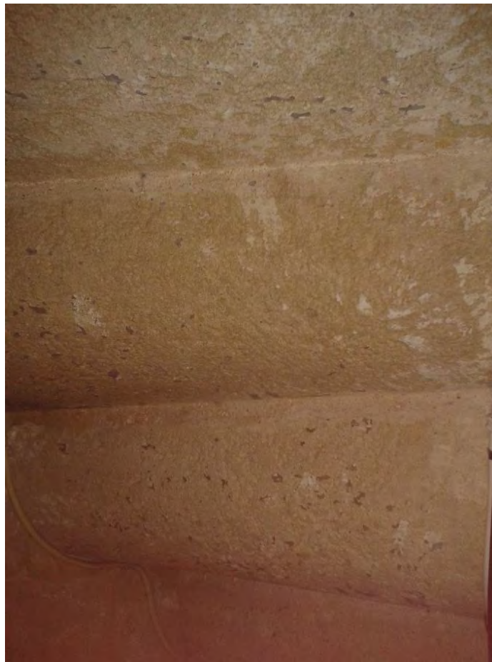
Detalle de la escalera de acceso al campanario, donde vemos detalles de restos del estado patológico de la piedra en algunas zonas
