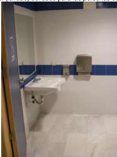
Figura 9. Interior (lavabo) del aseo para las personas con discapacidad.
