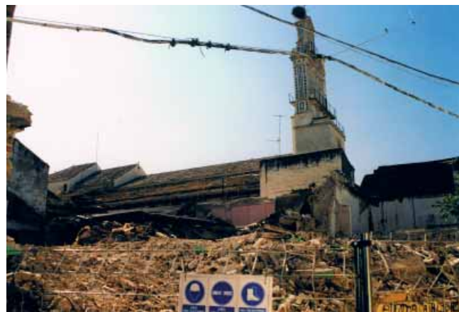
5 y 6. ESTRUCTURAS DEL CINE CABRERA DERRUMBADO. SE OBSERVAN LAS ARCADAS PERTENECIENTES AL REFECTORIO DEL ANTIGUO CONVENTO. FOTOGRAFÍAS TOMADAS POR ANTONIO MARTÍN PRADAS EL 13/05/2002.
