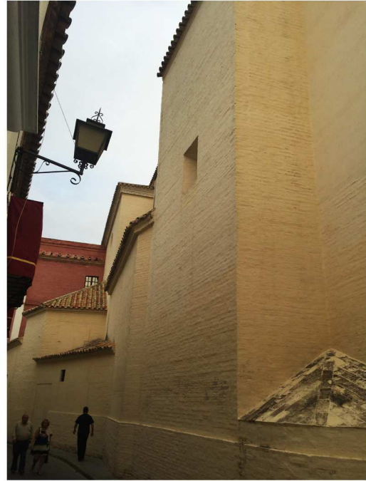
Lám. 8. Estado actual tras la restauración. Se aprecia que los esgrafiados han desaparecido. ICG.
