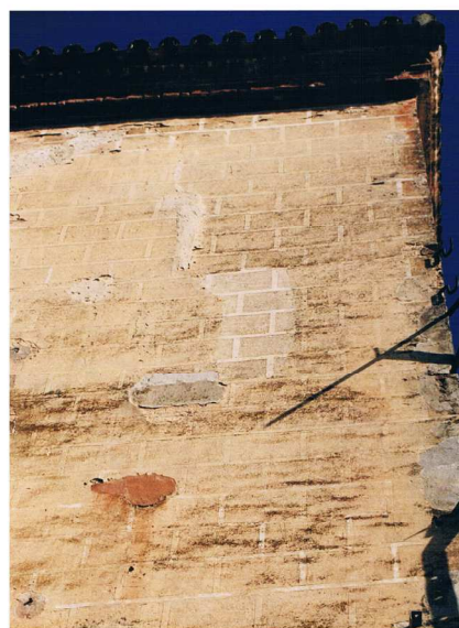
Lám. 6. Esgrafiados de sillares en el lateral de la iglesia de Los Descalzos. AMP.
