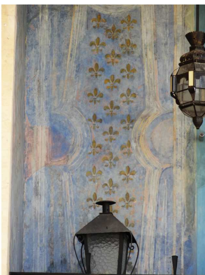
Lám. 53. Detalle de las pinturas murales aparecidas. 21 de septiembre de 2013. ICG.
