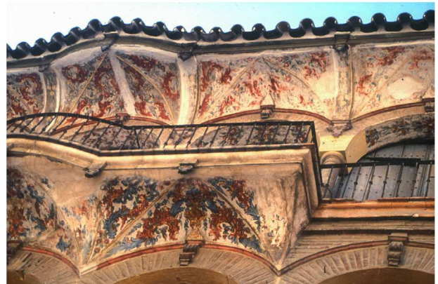
Lám. 42. Guardapolvos de los balcones de la casa del gremio de la Seda antes de su restauración. 15 de marzo de 2001. ICG.
