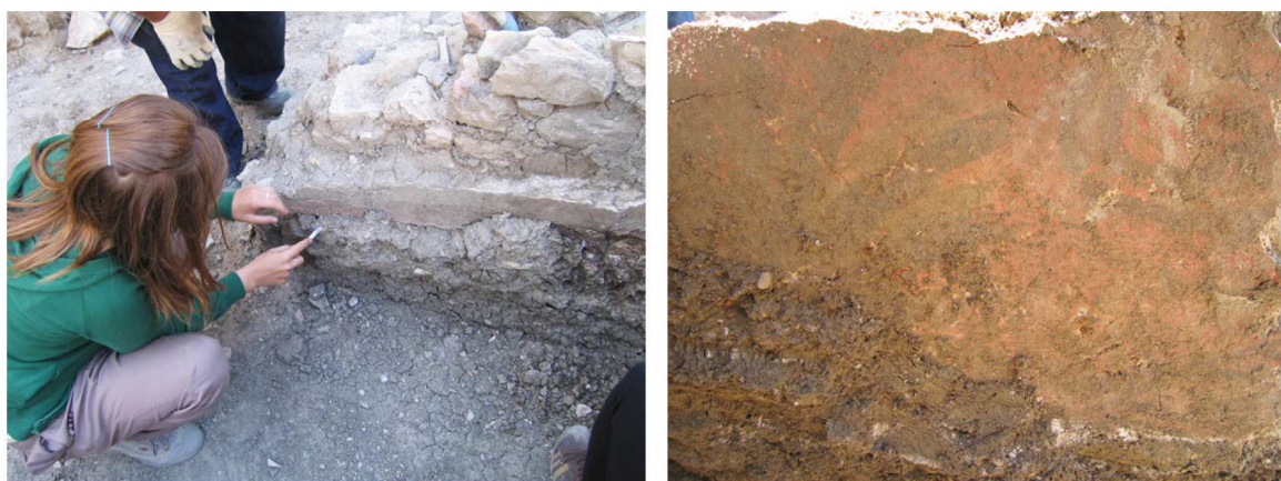
Lámina 9. Trabajos de limpieza y consolidación de pintura mural en la intervención arqueológica llevada a cabo en la calle Elvira nº 3 esquina a calle Fernández Pintado nº 5. Fotos: Juan Manuel Huecas. [55]
