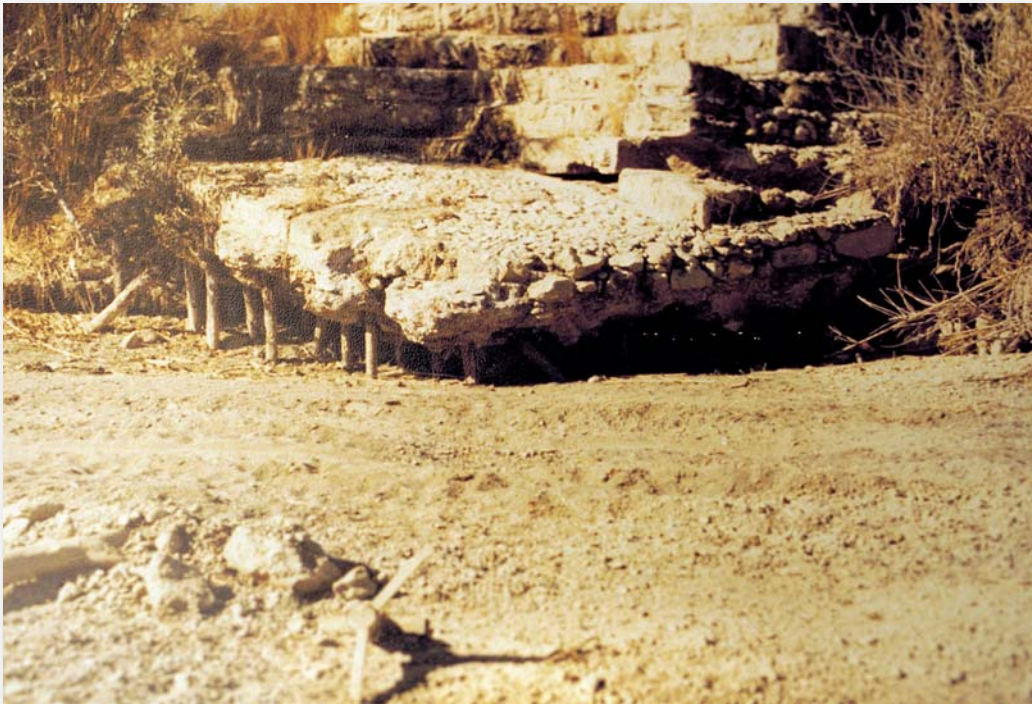
Encepado de pilotes de una de las pilas desaparecidas
