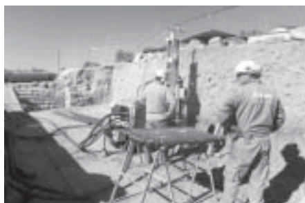
Trabajos en el muro norte de la curia (sondeo previo, desmonte y micropilotaje)
