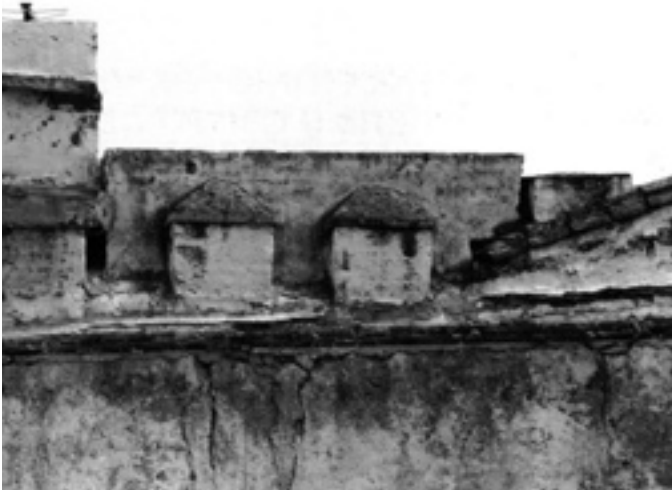
4.-Almenas del muro del castillo en las obras de derribo del antiguo Palacio Episcopal.
