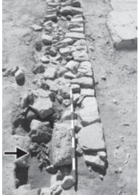
Situación de la T-10 en la cimentación del muro de fachada de la basílica
