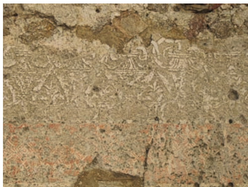
Restos de pintura mural en la fachada
