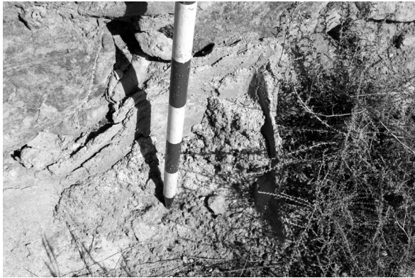
Lám. 32: Restos de enlucido de yeso en el muro anterior. Pueden apreciarse hasta tres capas superpuestas.
