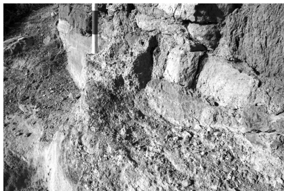
Lám. 12: Detalle de la puerta, donde pueden apreciarse los dos morteros de yeso, grisáceo y rosáceo, superpuestos.
