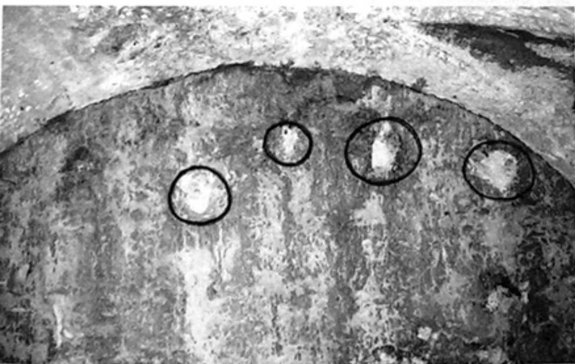
Foto núm. 12. —Lienzo sur del tercer calabozo. Se aprecian las cuatro marcas de mechinales donde se alojaron las argollas para encadenar a los reclusos colgándolos de la pared. (Sánchez Tostado, 1995).
