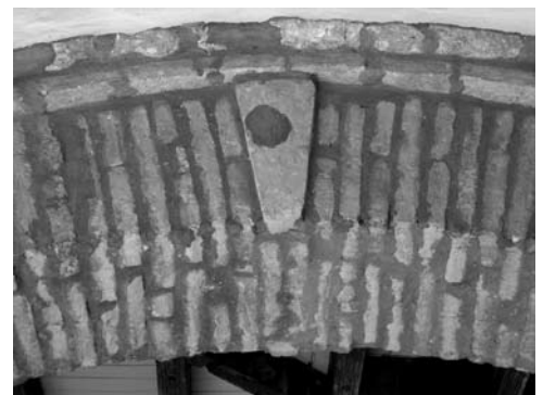
Arriba: Arco estructural construido con tablones coloniales. Obsérvese la clave del arco, pieza especial también fabricada en cerámica. Claustro de Santo Domingo.
