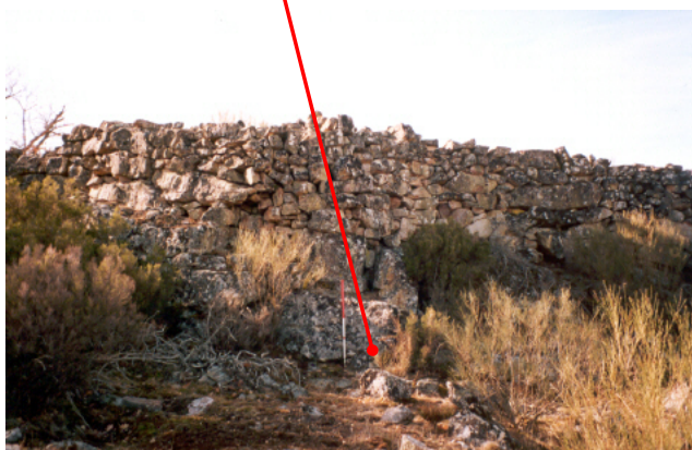
Fig. 312 a 314: Dos puntos de la muralla 2 donde se observa el zócalo de piedra cortado sobre el que se construye la muralla.
