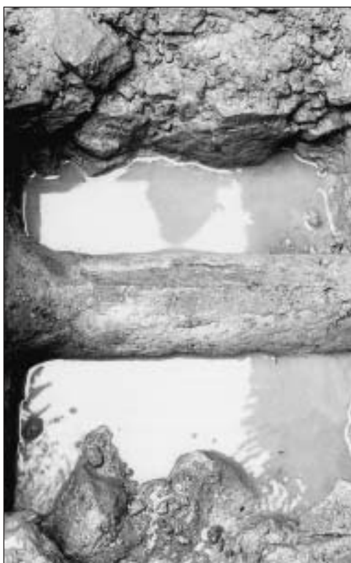
Tubería de plomo para salida del agua
