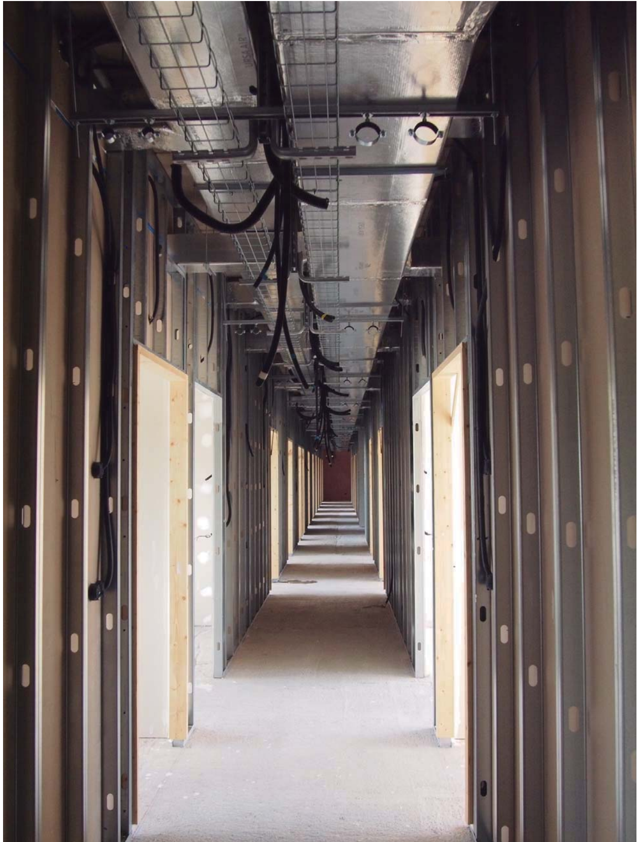
Fig. 47 – Pladur y carpintería metálica. Se aprecian las bandejas de instalaciones
