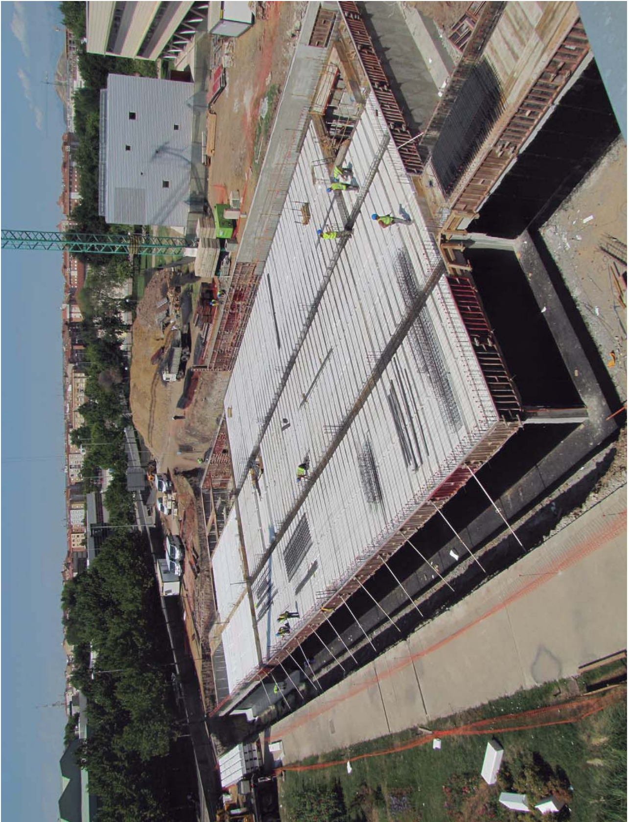
Fig. 11 – Colocación de las prelasas del forjado de la planta sótano, y las armaduras de las vigas
