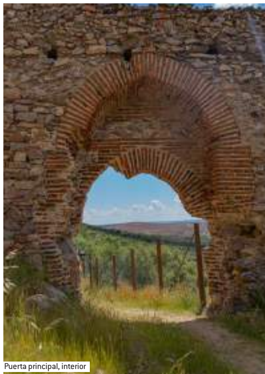
Obras de restauración torre del castillo (abril de 2019, foto Rodríguez de Ledesma)
