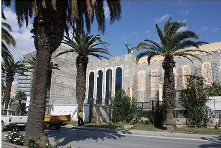
30. Complejo Cultural Cité de la Culture en la Avenida Mohamed V de Túnez capital, en construcción. Detalle. Marzo de 2010.
