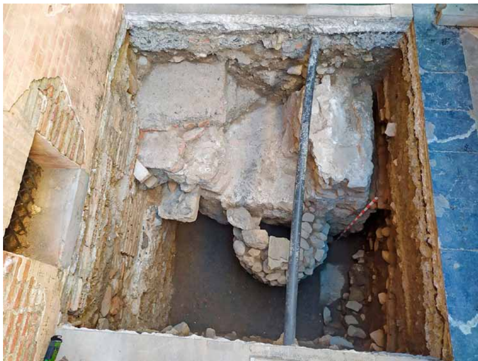
Figura 16 Vista Superposición y afección recalce al contrafuerte de la Mezquita
