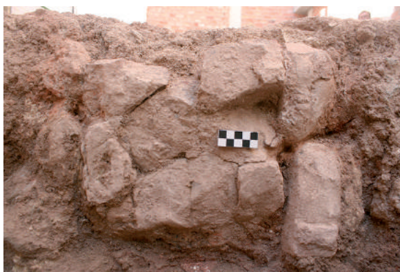
Fig. 29: Horno de parrilla HP-A. Estribo (U.E. 70) de arco de la cámara de fuego (lado Sur), que deja al descubierto la mampostería de base por pérdida del enfoscado arcilloso.
