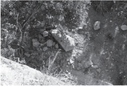
Tajo del Adarve. Desprendimiento.
