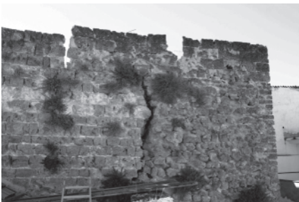
Detalle de la unión del Lienzo 1 con la Torre 1-7 (al interior), muy afectada por la sismicidad histórica.
