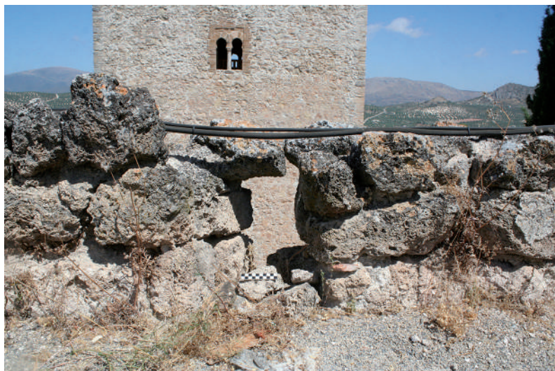
Fig. 55: Lienzo 1, paradós, aspillera 2. Es la mejor conservada de este paradós, con parte de la bovedita de cubierta. Estado previo a la intervención.
