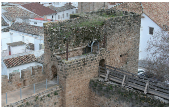
Fig. 26: Torre 3. Estado anterior a las obras, con desmantelamiento parcial ejecutado en 1977 como previo a una reconstrucción inconclusa que no se ha culminado hasta la intervención de 2019-2020.
