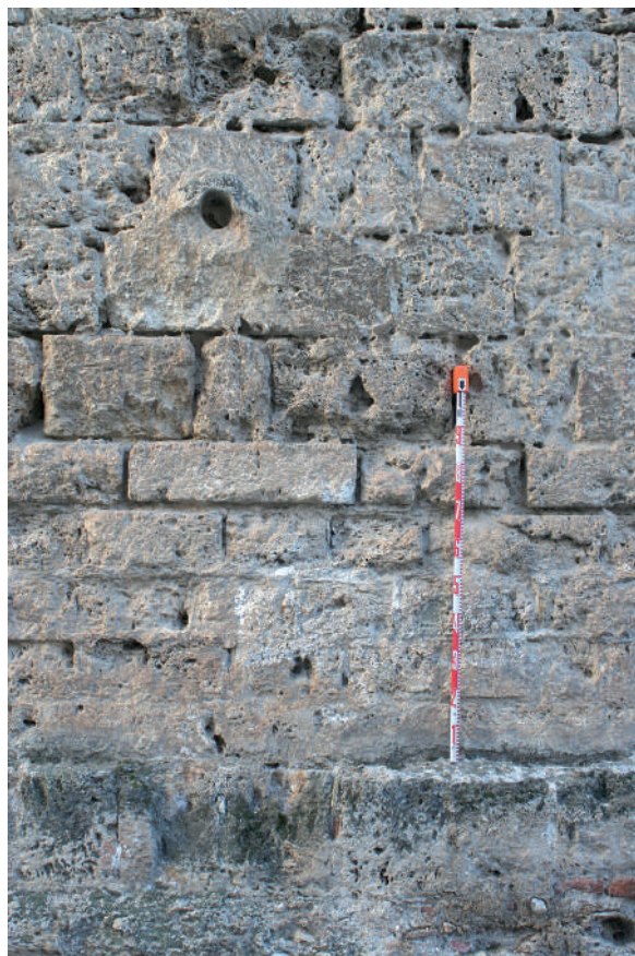
Fig. 41: Las cinco hiladas inferiores de las murallas y torres del sector intervenido están conformadas por sillería colocada por la tabla, y no por el canto, que es el estándar constructivo. Torre 3, lado c.
