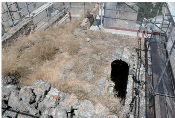
Fig. 23: Torre 3, terraza. Aspecto desolador que mostraba antes del inicio de los trabajos, con pérdida del garitón de salida. Los parapetos, aspilleras y pavimentos se hallan arrasados, y se observa una merma importante en la masa del volumen de ampliación de la torre sobre el Lienzo 3 (ángulo superior izquierdo).
