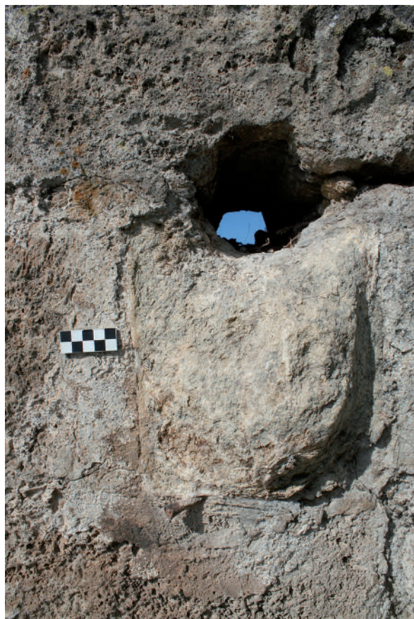
Fig. 65: Torre 2, lado c, exterior. Gárgola. Obsérvese el proyectil impactado en el ángulo inferior izquierdo.
