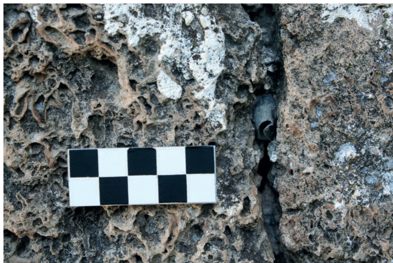
Fig. 127: Bala de plomo impactada en el Lienzo 1, exterior. Siglo XIX.
