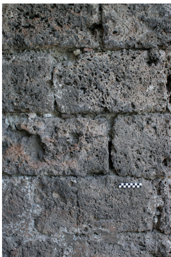
Fig. 37: Ejemplo de estereotomía cuidada en el corte y colocación de la sillería. Originalmente las juntas quedaban desdibujadas por un rejuntado muy ancho que aquí se ha perdido por erosión. Lienzo 2, exterior, a media altura.
