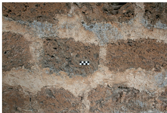
Fig. 35: Rejuntado original medieval conservado en distintos paramentos del sector intervenido. Torre 2, lado a.
