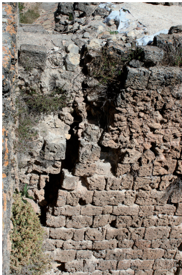
Fig. 24: Lienzo 1, exterior. Ejemplo de daño estructural provocado por movimientos sísmicos.
