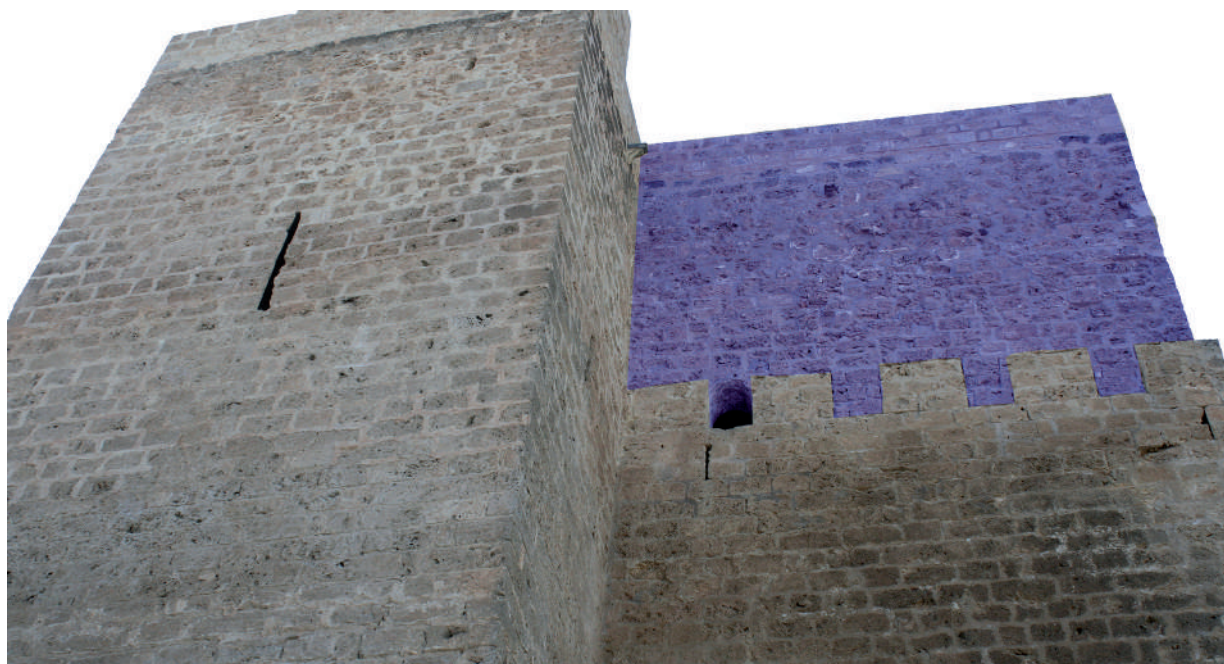
Fig. 56: Ampliación de la Torre 3, marcada en color, que monta sobre el Lienzo 3 y fosiliza cinco merlones originales medievales, parapeto completo y dos aspilleras.
