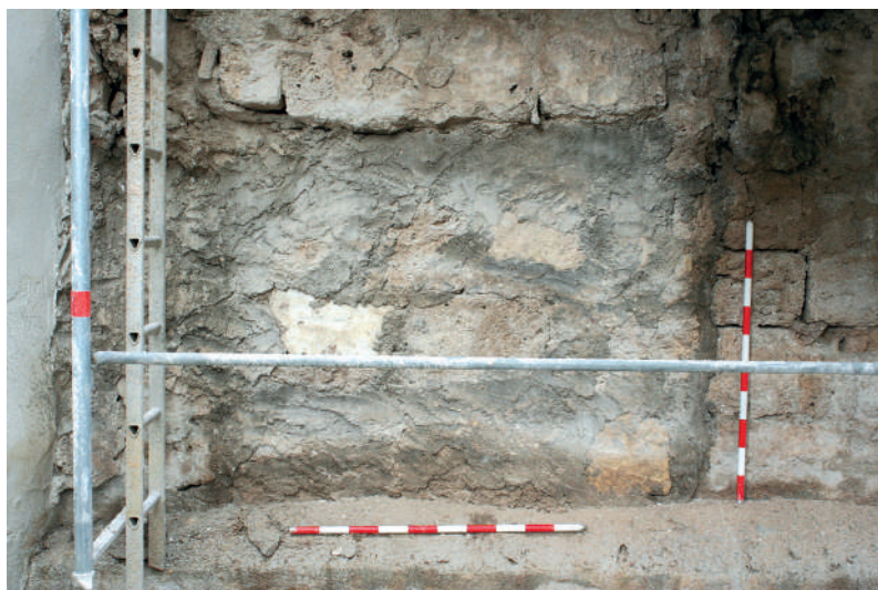
Fig. 118: Torre 1, lado b, base. Estado previo de la refacción paramental que oculta un minado amortizado.
