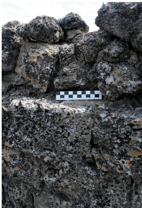
Fig. 59: Torre 2, lado a (exterior), terraza. Ejemplo de interfaces de destrucción del parapeto original fundacional (sillería) y recrecido postmedieval con estructura de mala calidad (mampostería).
