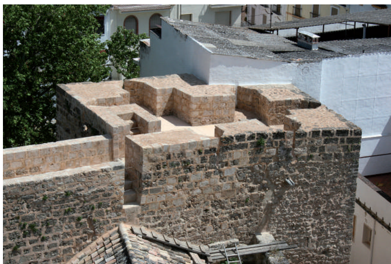
Fig. 81: Aspecto final de la Torre 1, tras su consolidación formalizando la cota máxima conservada del desmochado practicado en el siglo XIX. Se reconocen las distintas cámaras de tiro, así como las escaleras de acceso a la terraza y las de conexión con el Lienzo 8. La gárgola de evacuación de aguas pluviales se ha incorporado como necesidad durante las obras de 2019-2020.
