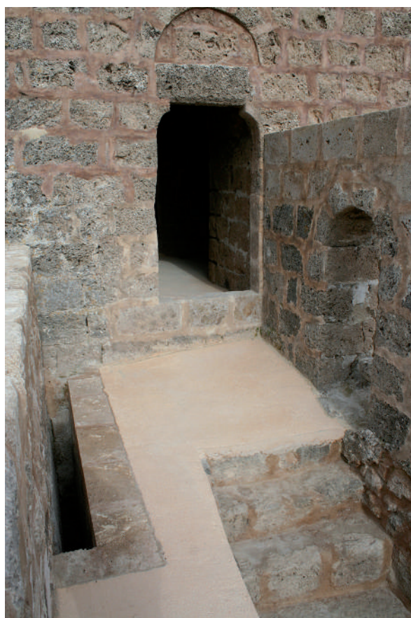
Fig. 50: Acceso a la Torre 2 desde el adarve del Lienzo 1, con mortaja del rastrillo (izquierda), acceso a la ladronera (derecha) y un tramo de la escalera doble del acceso directo desde el interior de la fortificación. Estado final previo a la instalación de protecciones de seguridad. Se puede observar la entrada muy elevada al interior de la torre y la pendiente del pavimento del adarve, reflejo del medieval infrayacente.
