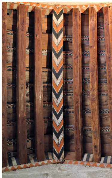
Sección poniente de la cumbra de la iglesia de San Miguel de Barluenga. (Foto: M. a Celia Fontana Calvo)
