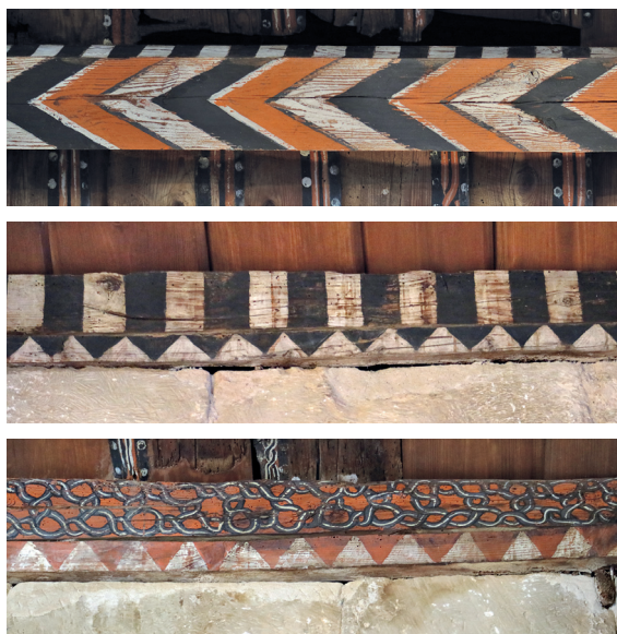
Detalles decorativos de la sección poniente de la cumbra (arriba) y de la solera (centro y abajo). (Fotos de M. a Celia Fontana Calvo)
