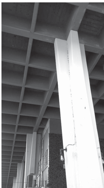
Figura 11: Detalle del basamento, las columnas y los casetones del Hotel de Turismo y Caja de Previsión Social, provincia de Formosa, Argentina, grupo URBIS (1970). Fuente: Fotografía de Ricardo Panero.
