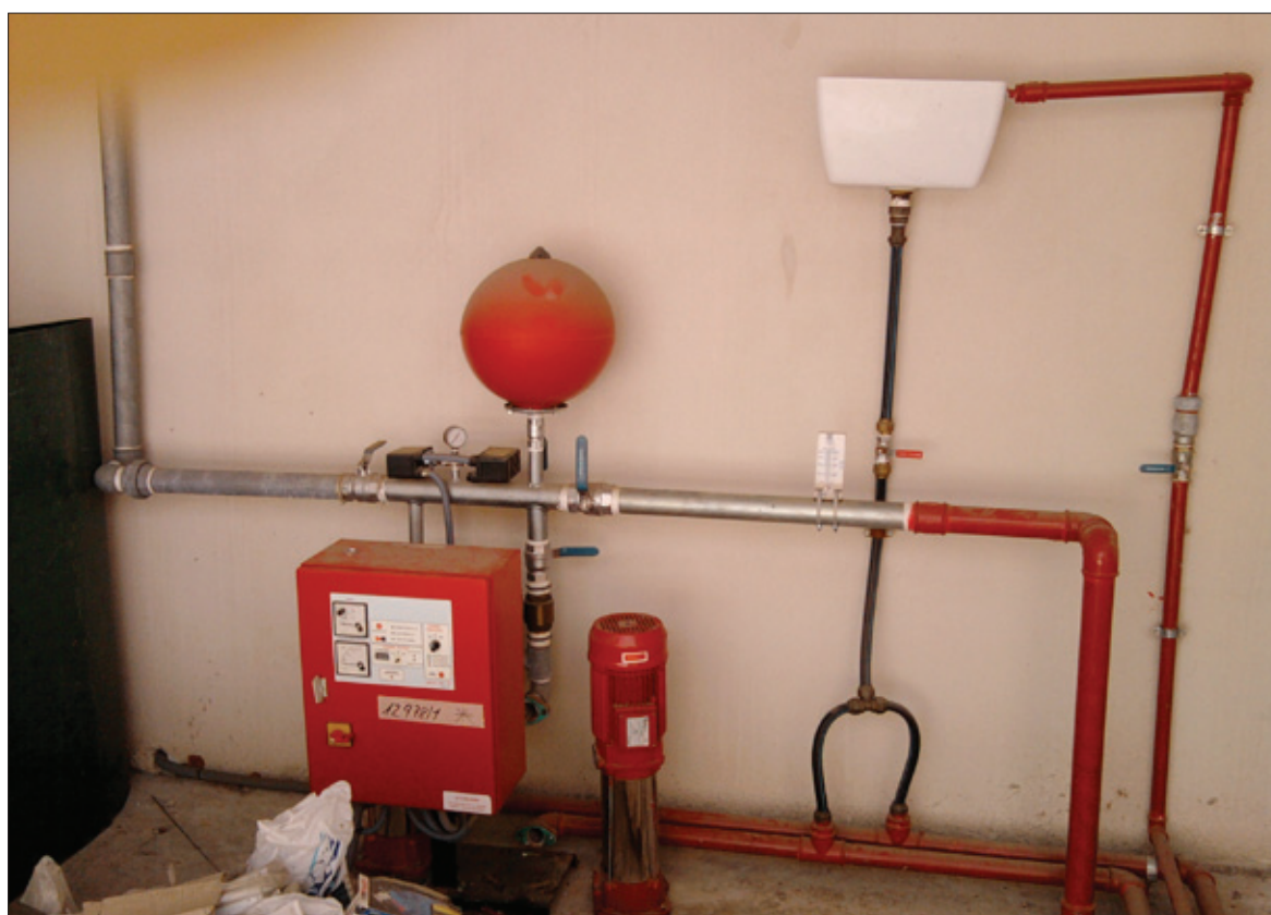
Grave deficiencia en abastecimiento de agua contra incendios, para B.I.E.S 7 en aspiración negativa. Concatenación de graves deficiencias, cuyo esperpéntico resultado es un sistema de cebado Made in Spain, conectado en la aspiración, de un equipo fuera de servicio. ¿Quién cometió los errores? ¿El proyectista, el instalador, el mantenedor? Es muy difícil de determinar, pero al final el resultado es el de siempre, la red de agua contra incendios totalmente fuera de servicio, y sin visos de solución, debido a múltiples factores, económicos, desconocimiento y/o dejadez del propietario, etc.
