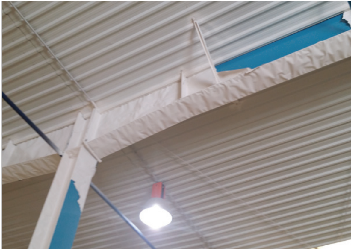
Grave deficiencia en empresa con N.R.F medio nivel 4. Pintura intumescente (protección pasiva), mal aplicada, mal mantenida y con claros síntomas de deterioro. Deficiencia agravada por el transcurso del tiempo sin solucionar.
