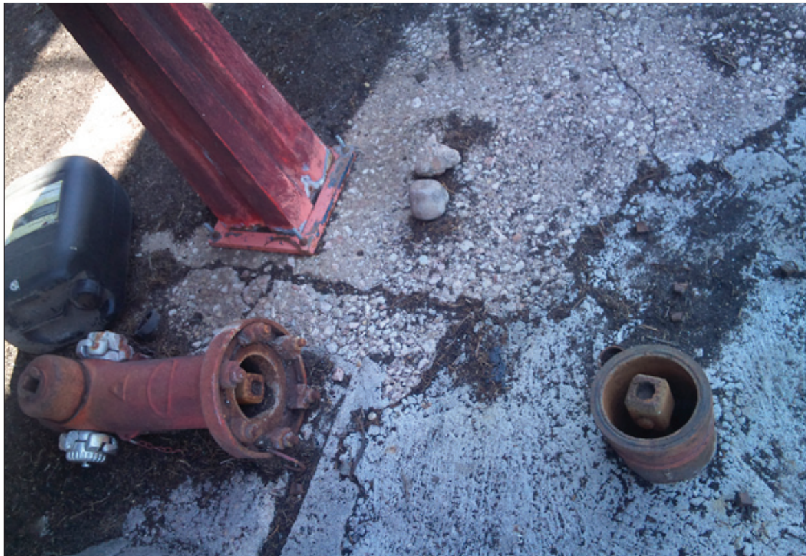
Grave deficiencia en empresa con N.R.F Alto nivel 8. Hidrante de superficie arrancado por un vehículo. Red de hidrantes contra incendios, totalmente fuera de servicio (protección activa). Deficiencia agravada por el transcurso del tiempo sin solucionar.
