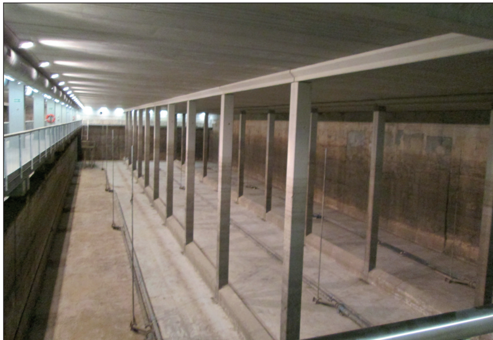
Figura 5. Tanque Anticontaminación ingeniero José Manuel Obrero Díez (Barrio de San Gabriel, Alicante)
