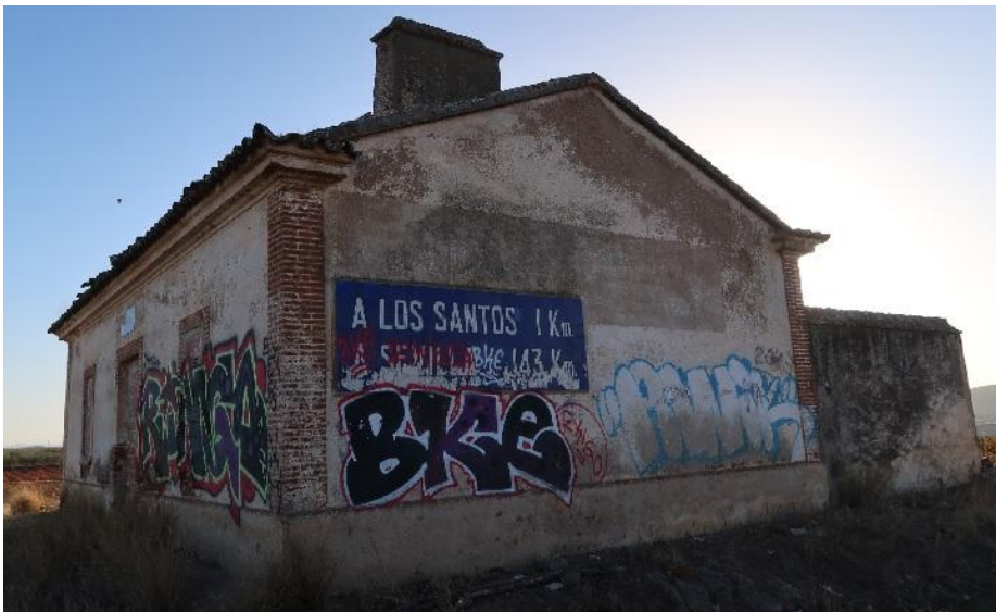
Fig. 43: Pobre estado de conservación de la “Casilla de Peones Camineros” situada en la N-630, en dirección a Mérida, dentro del término municipal de Los Santos de Maimona.
